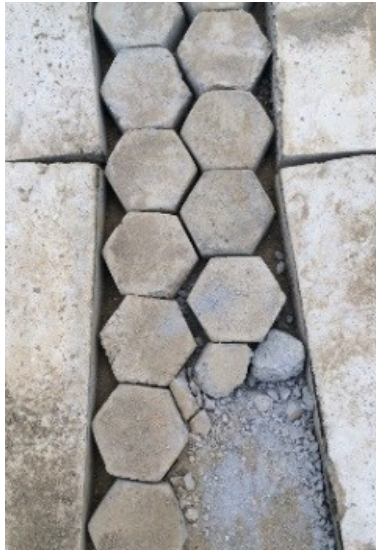
図 6. 目地砂（拘束）無しの載荷後の状態
