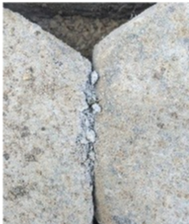
図 7. 隣接ブロック間の摩擦による破損
