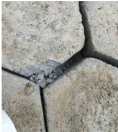
図 8. 車両荷重によるブロックの隙間からの欠け
